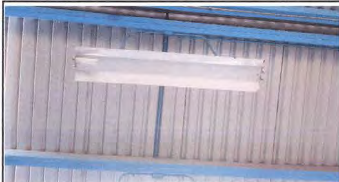
Foto 13: Sustitución de lámparas tipo LED
